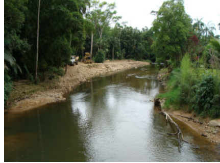
Foto 2: Rio Sagrado de Cima: Extração de areia e cascalho na margem esquerda do Rio Sagrado.
