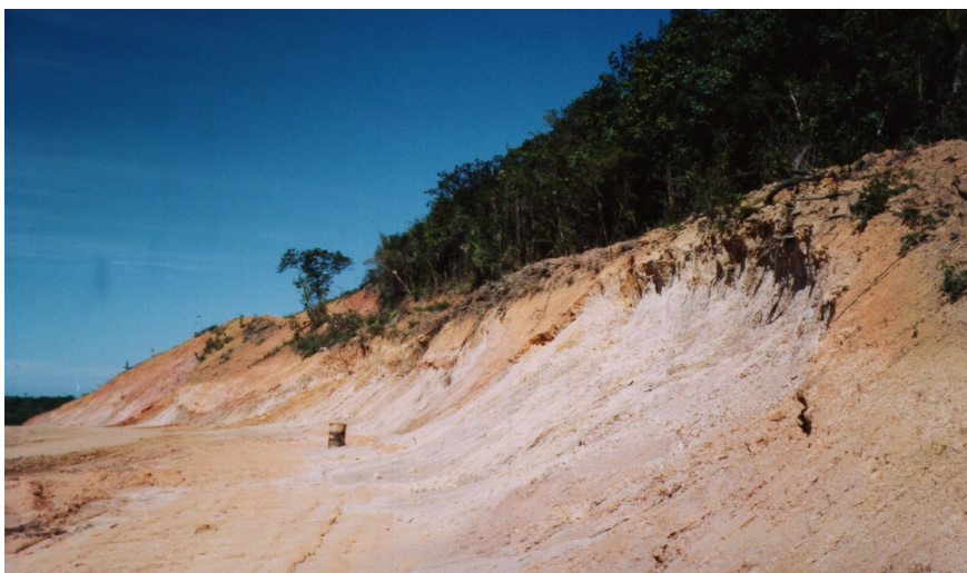
Figura 4: Taludes com escorregamentos. Acima, mata (invasão de APP)
